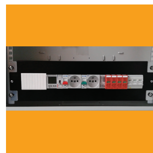
příklad osazení v rozvaděči Solarix LC-18
